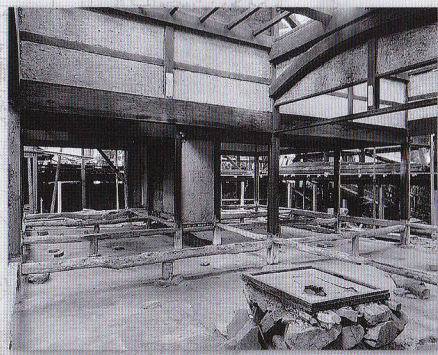
保存修理工事は、上屋軸組はそのままにして、下屋と附属建物を全解体する内容で修理が行われました。手前ダイドコロ中央には囲炉裏が構築され、軸組は、太い柱と胴差しなどで整然と頑丈に組固められていました。当初、ダイドコロと隣室のシモデンは一部屋の広間でした。
